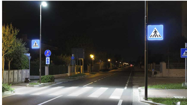
Esempio di illuminazione di attraversamento pedonale
